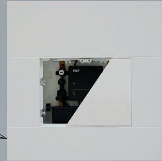
Nahezu unsichtbar Unterputz // Einbindung im Fließenspiegel
