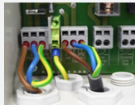
Alimentation en électricité de l'installation 1 ; 2 ; 3
