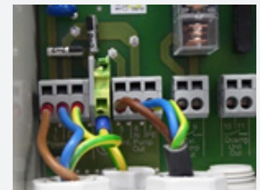
Alimentation en électricité de la pompe 5 ; 6 ; 7
