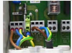
Alimentation en électricité de la pompe 5 ; 6 ; 7
