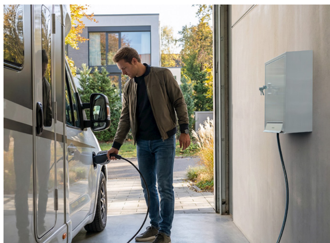
Stroomvoorziening voor particulier gebruik – goed beveiligd tegen toegang door onbevoegden.
